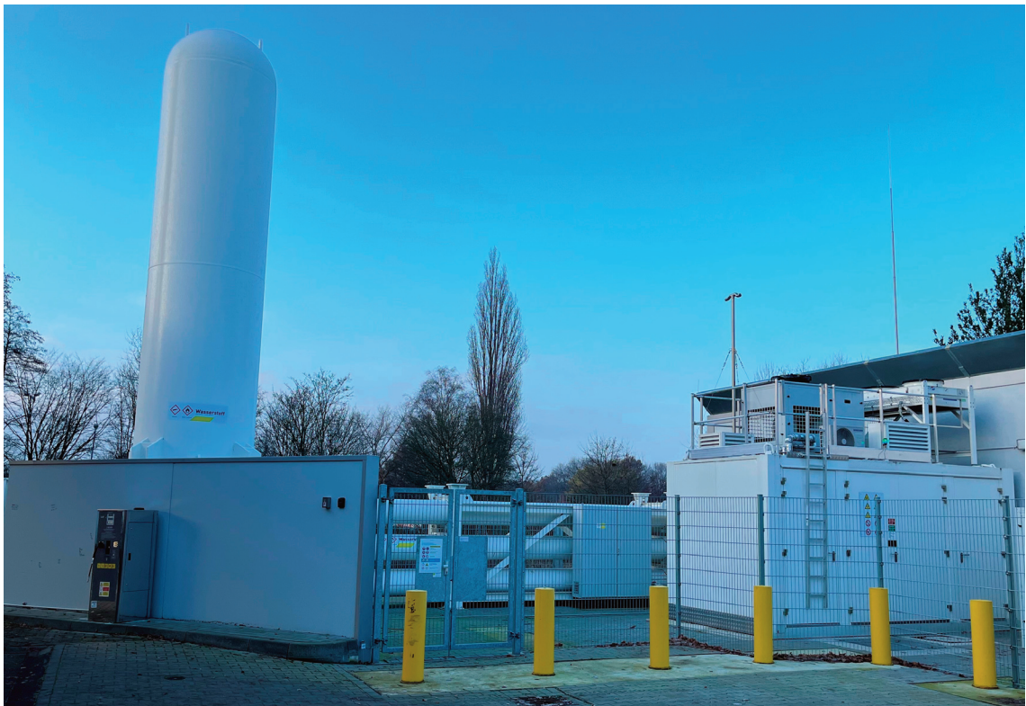
„Behind the Scenes“: H 2 -Tankstelle in Oldenburg
